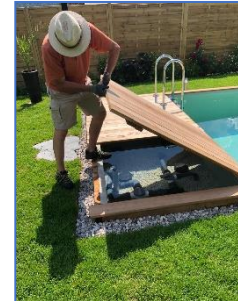
Freier Zugang zur Filtertechnik
