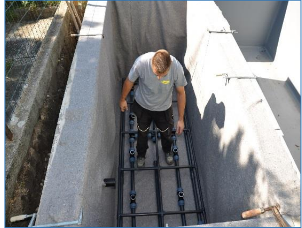
Bubble Leitung mit den Löchern nach unten auf die bereits eingebrachten Leitungen legen
